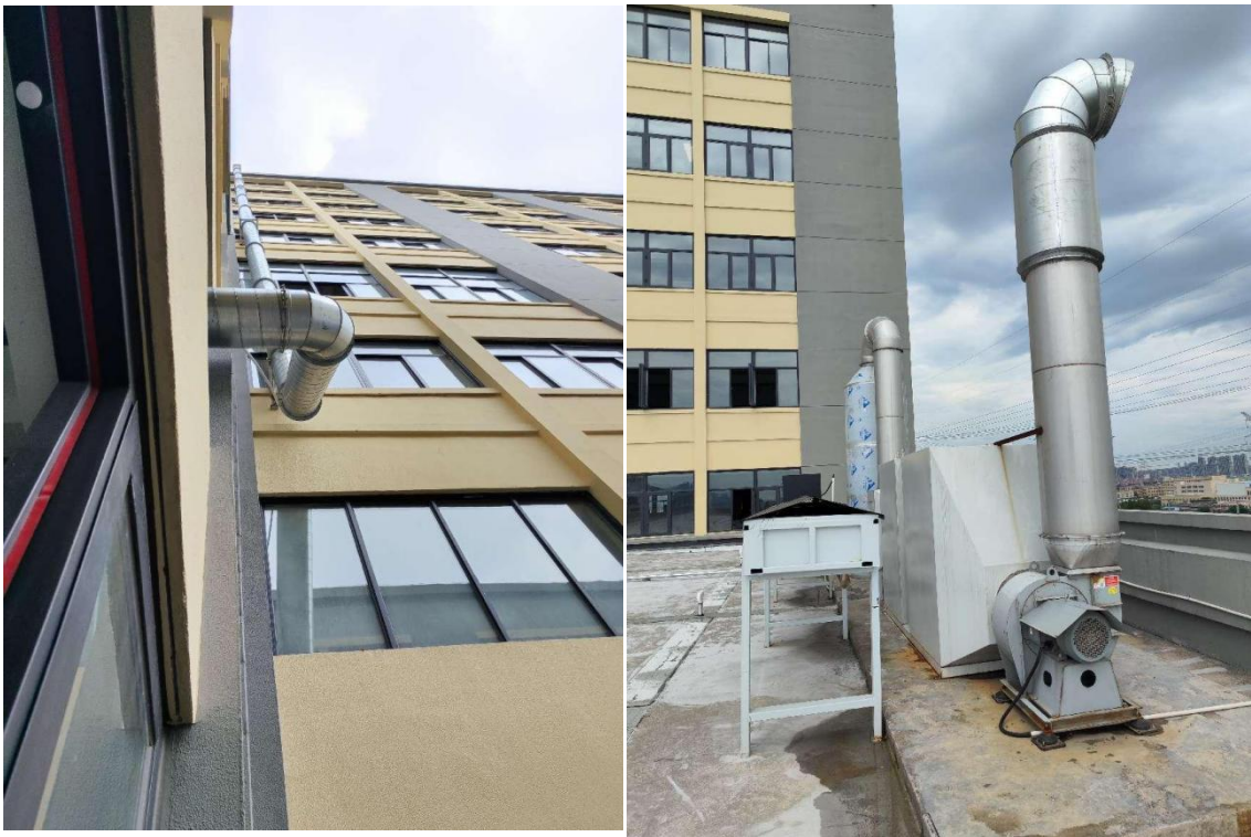
图 4.1-2 废气收集处理措施（左侧为收集管道，右侧为处理装置）
